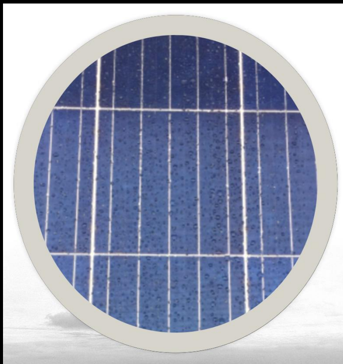
Água de chuva não escorre facilmente
